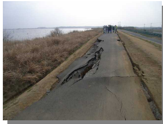
東北太平洋沖地震による被害(余郷入堤防)
