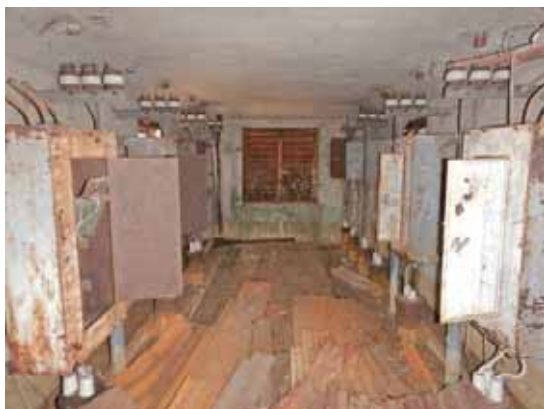
配電室内部の様子
