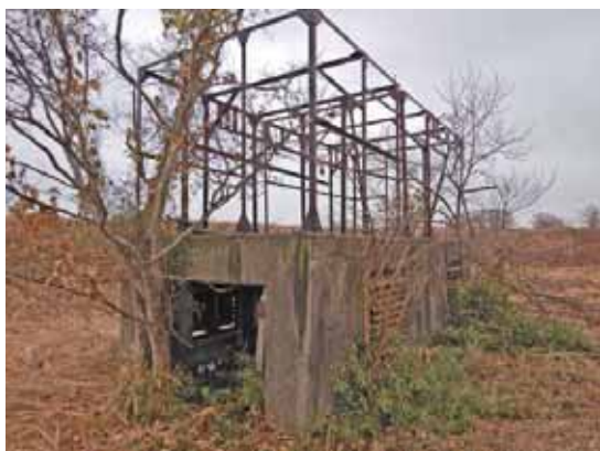
配電所 東側から
