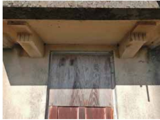
庁舎 3 階塔屋南面の底
