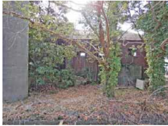
汽缶場北側 西側ボイラーを囲う煉瓦が突き出ている
