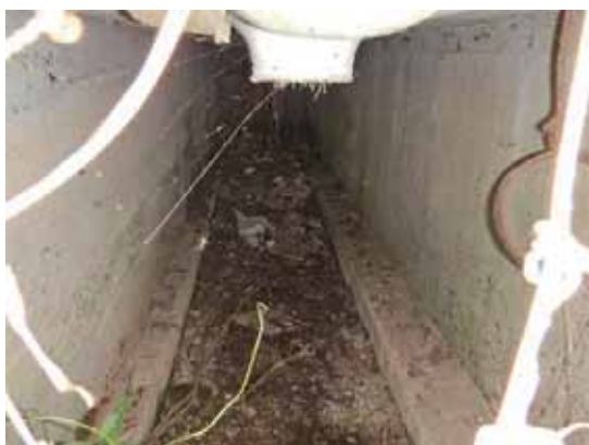
通信講堂便所 東側基礎部分 南側の崩れた部分から内部を撮影
