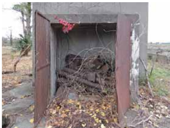
不明建築物 西面の収納 収納内にはパイプ管が収められている
