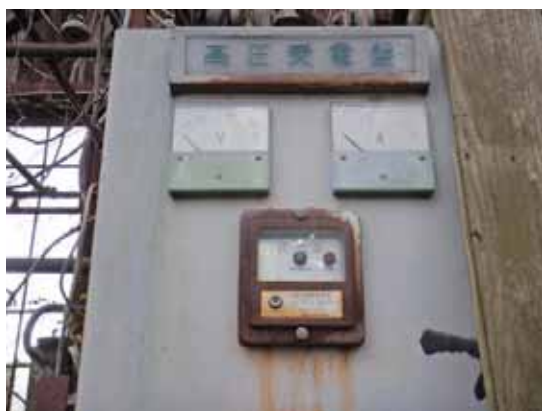
分院時代に設置された高圧受電盤
