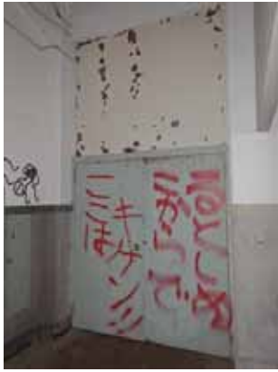
庁舎 2 階中央廊下を区切る防火戸
