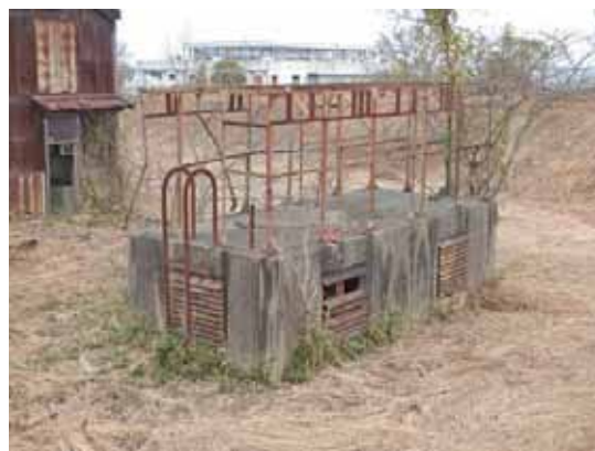
配電所 南西側
