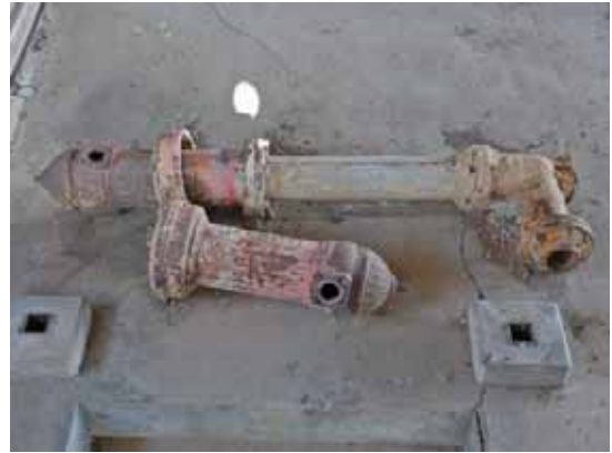
自動車庫内の消火栓
