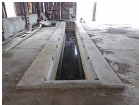
整備用のピット ピット内には水が溜まっている。
