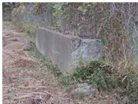
通信講堂便所 東側基礎部分 基礎の西面の一部がフェンスから突き出ている。
