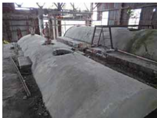
ランカシャーボイラー上部 モルタルがひび割れている
