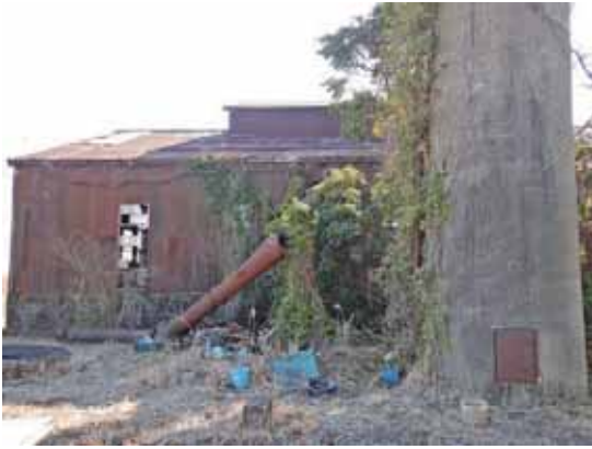
汽缶場北側 縦型ボイラーと接続していた煙突が折れている
