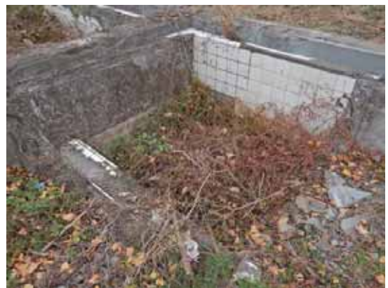
躯体に残るタイル
