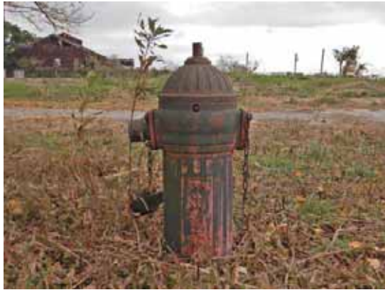
消火栓 西側から
