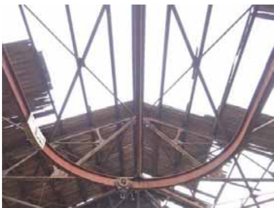
天井部に設置されたU字型のレールとチェーンブロック
