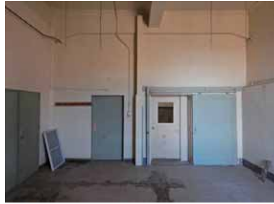
庁舎1階(A2) ドアが増設されている
