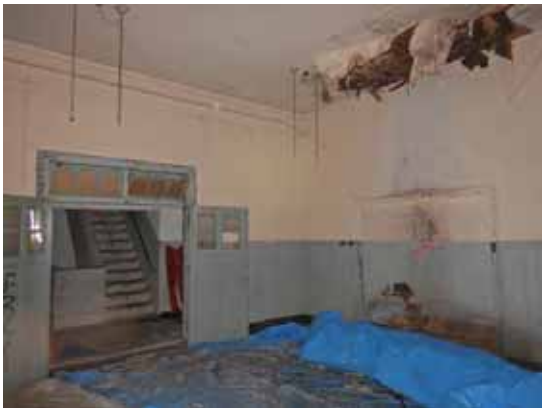
庁舎 2 階 (B20) 天井部が崩れ雨漏りしているため、ブルーシートが敷かれている。
