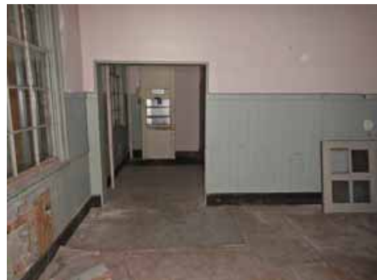
庁舎1階(A17) 奥に小型昇降機が見える
