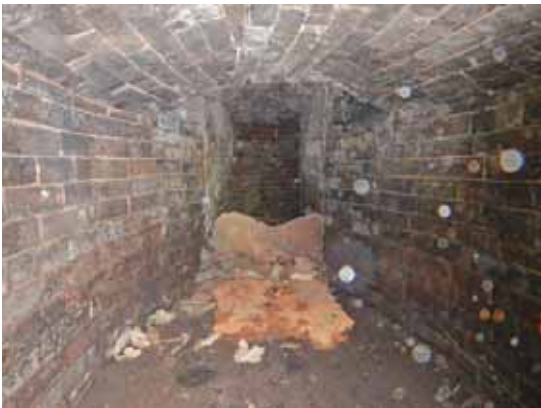
煙道 煙突方向
