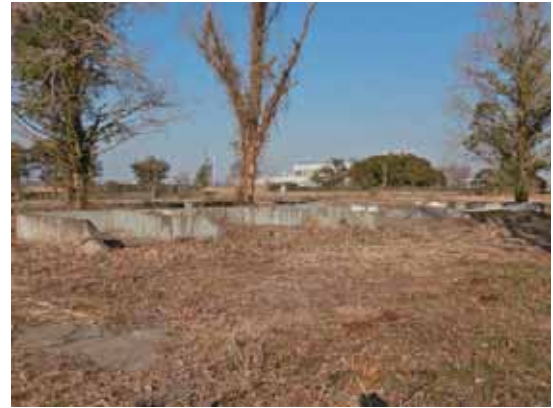
士官浴場 南側から 基礎の南側が崩れている。
