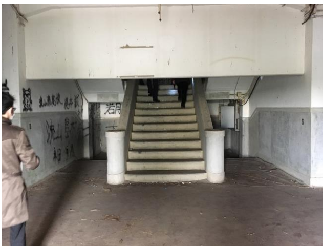
庁舎正面玄関（落書きが多い）
