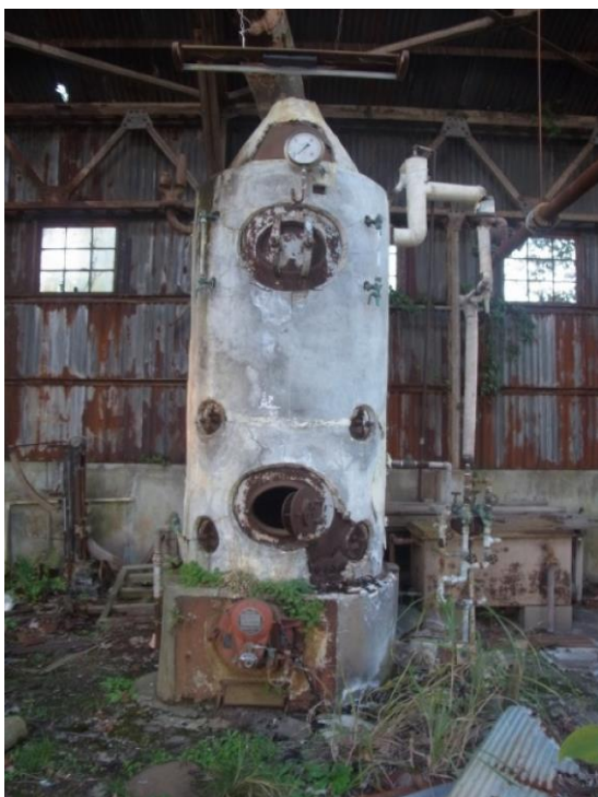
分院時代後期に使用された重油ボイラー
