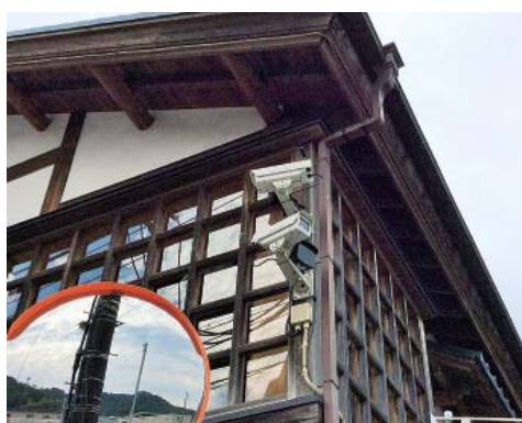
防犯カメラの設置状況
